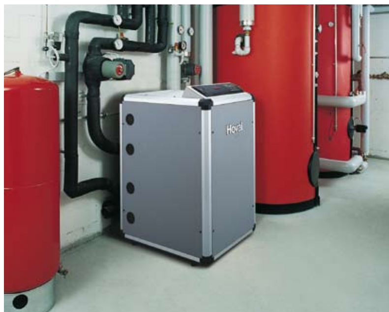
Impianto Hoval Thermalia® con accumulatore e sonde geotermiche.
